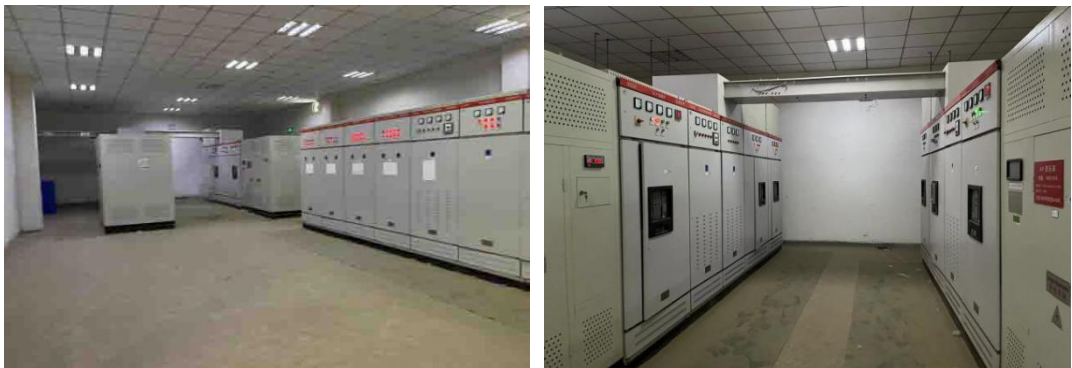
图 2-4 厂区现有供电设施
