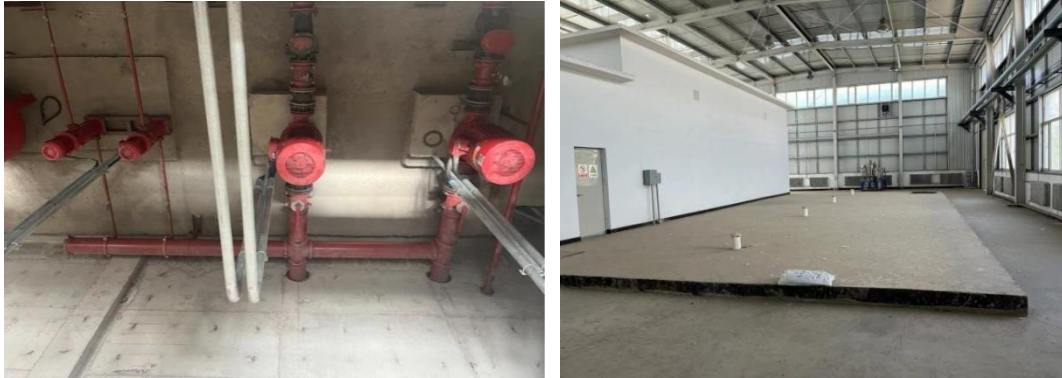
图 2-2 厂区现有消防水泵房
