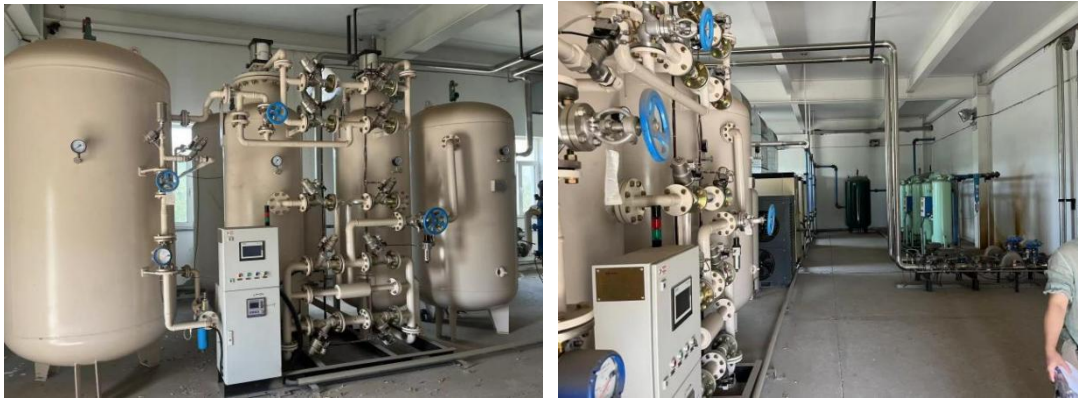
图 2-5 厂区现有空压站
